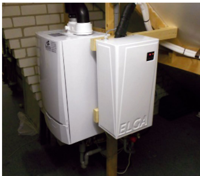
Een voorbeeld van een opstelling van een hybride warmtepomp (bron: BDH)
